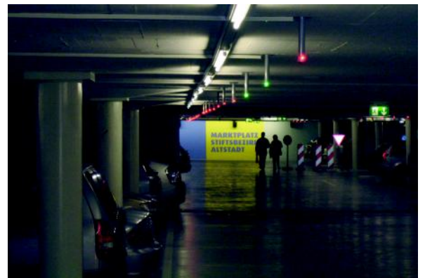
Platzleuchten in der Fahrgasse zeigen die Parksituation an
